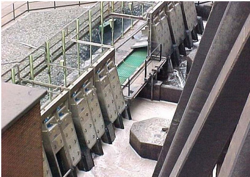
14 laiptinių groty STEP SCREEN® SSV kolonų aušinimui elektrinėje Pietų Afrikoje
